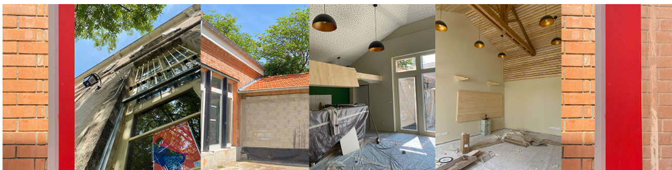
Travaux dans le cadre du plan de relance - Tiers-lieu le M!|lieu] à Sault (84) © Le M!|lieu]
